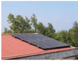
Bộ phận cung cấp điện mặt trời
