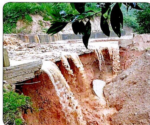
Hình 6.8. Công trình giao thông ở tỉnh Bình Định bị hư hại do sạt lở đất, năm 2021
