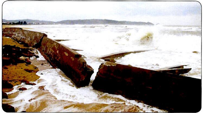
Hình 6.4. Bão số 9 gây hư hại bờ kè ở tỉnh Bình Định, năm 2020
