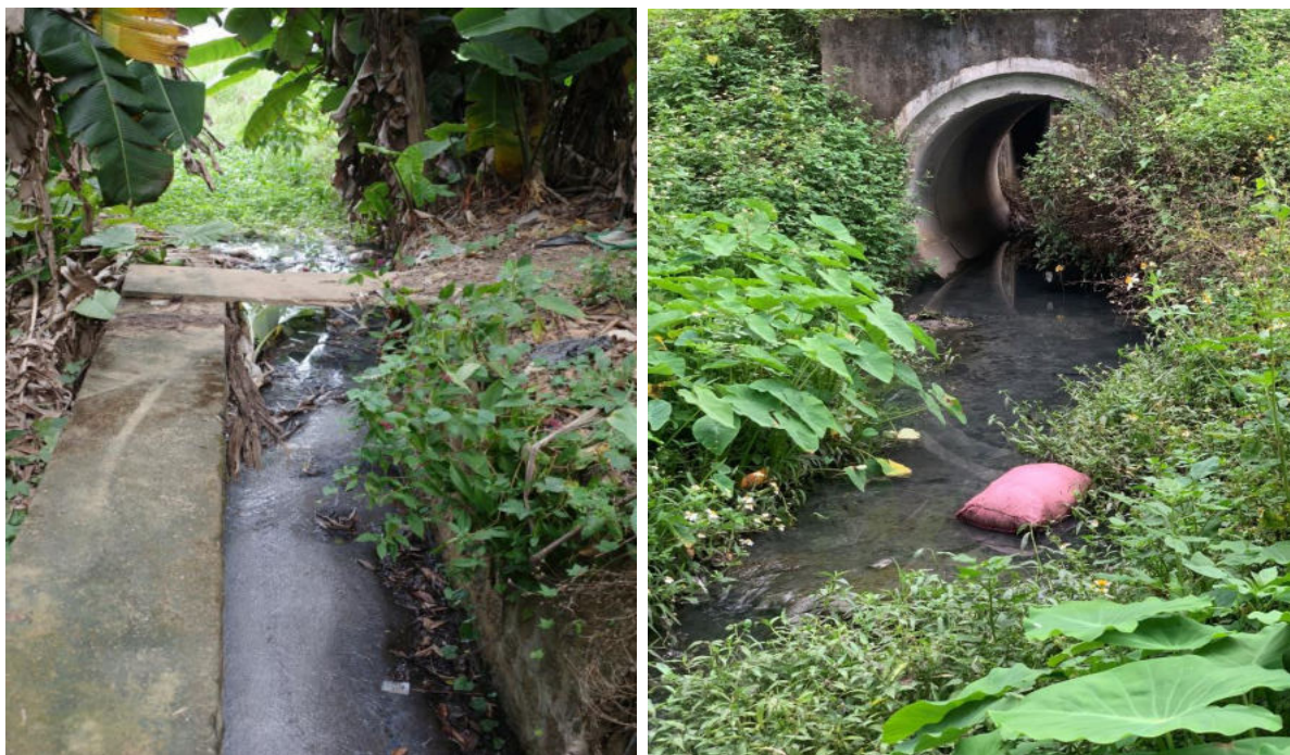
Hình 5. Công thoát nước thải trực tiếp ra sông Lại Giang
